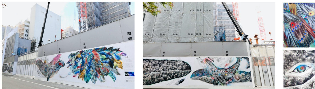
実際の現場風景：大阪の中心地でもある淀屋橋からすぐの現場。現場周辺はビジネス街でもありながら文化や緑も感じられるエリア。一部大小島による手書きの箇所も。（左・中 撮影：花坊）
